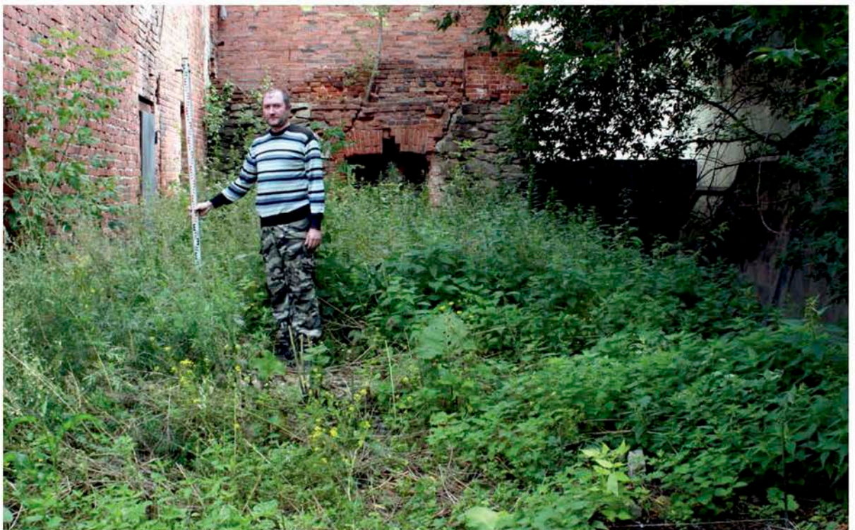
Рис. 18. Земельный участок с кадастровым номером 66:41:0401003:12, расположенный по адресу: город Екатеринбург, проспект Ленина, 18а. Южная территория земельного участка. Вид с запада.
